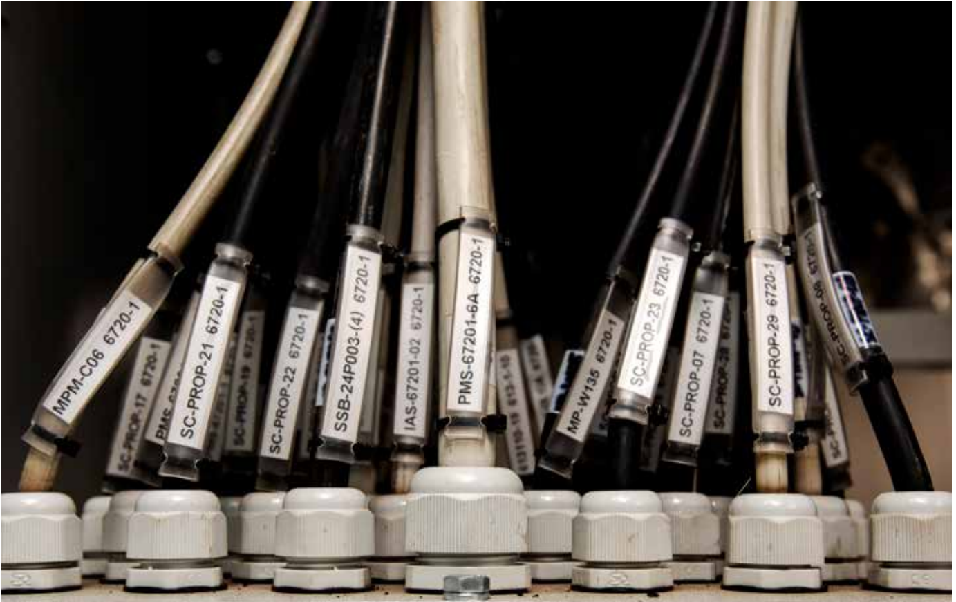
Grundproblemet med framdrivningen hänger ihop med överföringen av elektricitet mellan dieselmotorerna och elmotorn. Stora delar av kablage och styrenheter måste bytas ut för att fartyget ska kunna ge sig ut på havet.
